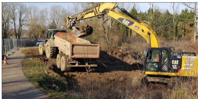
Les travaux d'assèchement du ruisseau débutent par la mise en place d'une tranchée vers le canal de décharge, afin de détourner l'eau de son lit.
